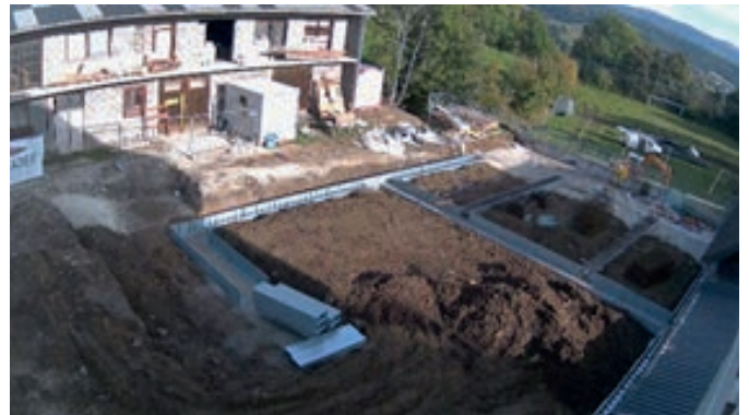
KW41: Unterbau, Abdichtungsarbeiten, Drainagen, Anschlussarbeiten an die Gemeindewerkstatt und die Räume der Sportunion Fischbach
